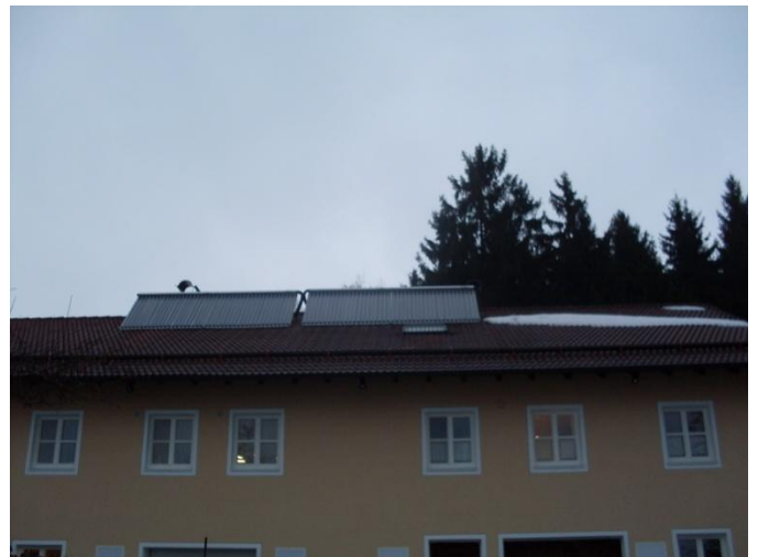
2010 montierte Paradigma Solaranlage in Rameröd
